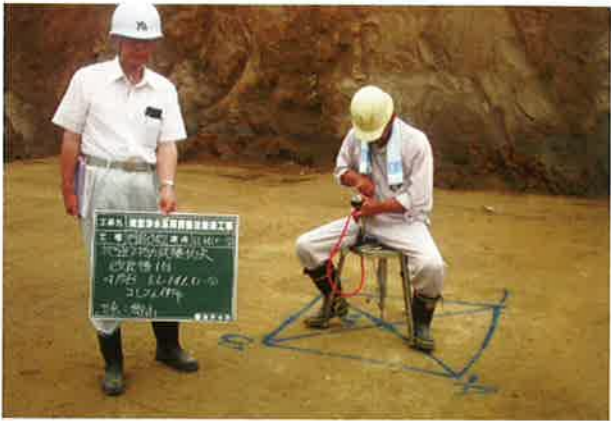
地盤改良後のPCタンクの基礎確認（7層7mの各段毎に広範囲確認 全50ヶ所以上）
